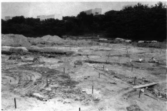
新築中の現場 トレンチの設置状況 西側より東側を望む
