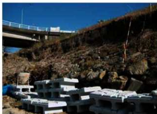
安津橋根元(右岸) 表出した石積
