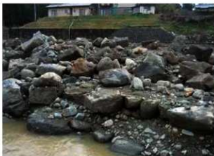
平成19年7月の被災により剥がれた石敷(左岸)②
