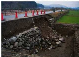
Ⅹ区 石積出土状況（崩壊後） 北東から
