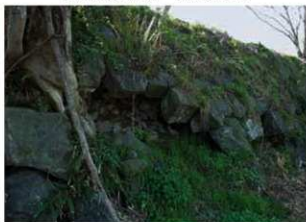
田口の柵 破損部分 石積下の裏込め石が見える
