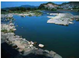
平成19年7月 被災後の鶺ノ瀬堰 洪水後の鶺ノ瀬堰 コンクリート部分・石畳部分ともに大きく壊された
