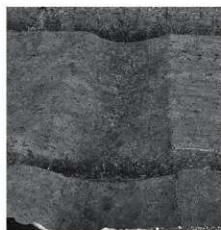
発露状況 (南より)
