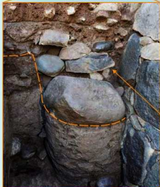
石門北側にある石垣(右)の修理痕跡
