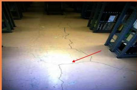
①建物内部 床クラック
