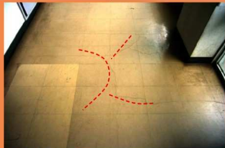
②建物内部 床クラック
