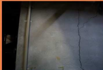
③建物内部 壁クラック
