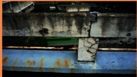
③劣化状況一例写真(屋上手すり)
