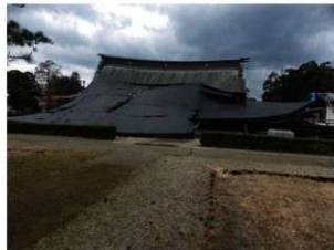
⑥丈六山妙厳寺本堂（珠洲市宝立町鶴岡）1883（明治16）年に再建した真宗の古刹。ほとんどの建物が倒壊していた。
