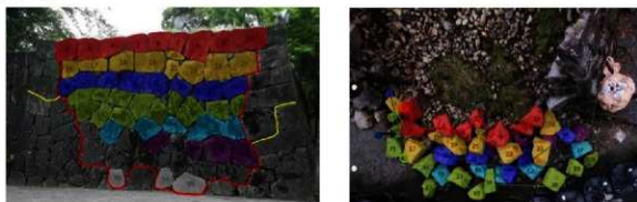
第3図 H99面石垣(北大手門周辺石垣)崩落解析図
