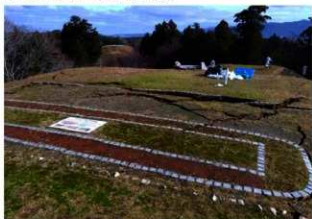
復元墳丘に無数の亀裂、葺石崩落
