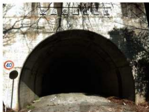
③宇出津第3隧道 トンネル出口の斜面崩落により通行止め。トンネル右側の山上に、宇出津港を一望できる熊野山塩谷寺がある。
