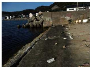
⑤真脇遺跡直下の高倉漁港（西側：能登町姫） 護岸に亀裂が入り、コンクリ片や木片が散乱しており、津波の痕跡がうかがわれる。
