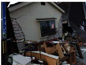
⑤輪島市河井町地区 河井浜に面する民家。1階部分はつぶれてしまっている。津波は来ていない。
