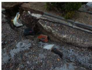
④地割れに生じた流路（落堀） 地割れに生じた戻り流れによる流路は緑石を壊し、隣の港の駐車場側（海側）へと続く。
