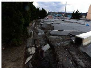
③地割れに生じた流路（落堀） 表層にはブランターやスーパーの買い物カゴ、植物遺体、コンクリート片、アスファルト片などが多数散乱している。
