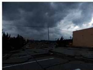
④「マツモトキヨシ珠洲シーサイド店」（珠洲市飯田町） 駐車場には大きな亀裂や地割れが生じていた。地割れに溜まった津波堆積物の珪藻分析を行った。
