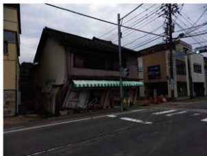
②宇出津病院前交差点（能登町宇出津）建物の応急危険度判定により、赤（危険）、黄（要注意）、青（調査済）の紙が貼られている。
