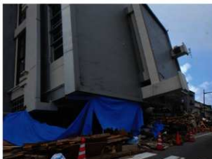
③「五島屋」ビル（輪島市河井町）震度6強。7階建てビルが倒壊した。ビルの中と押しつぶされた家屋からの懸命の救出作業が行われたが、助け出すことはできなかった。
