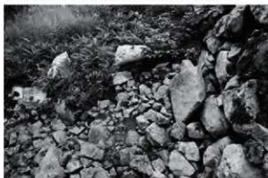
5 第3レンチ 本丸内曲輪石垣①崩落石材(南から)
