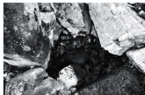
5 埋門 通路内崩落石材状況 (南から)
