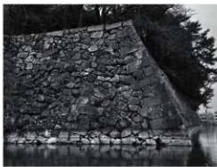
5 池田輝政が領地播州より運んだ竜山石による算木積が視認できる。
