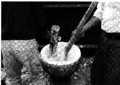
71 工事中 壁根工事 目詰めしっくいの下拵え 銀杏草とキブ瀬を加え良く搗き込み み使用時に再度搗く
