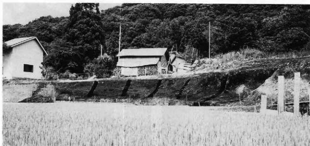
包含崩露出状況
