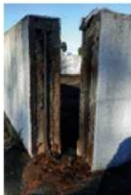
図65 建物の木柱下部の劣化 により生じた木腐
