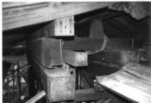
三府御門 桁と敷桁の離脱
