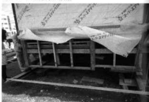
八通り外壁破損ラスモルタルドエアートックス
