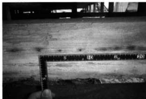
土台外面に残る和釘痕 腰板貼り跡
