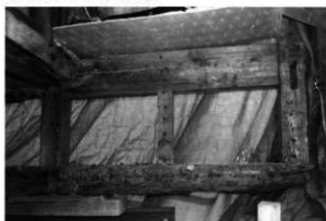
はノ一～二土台腐朽
