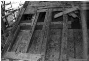
野タルキの腐朽、損傷
