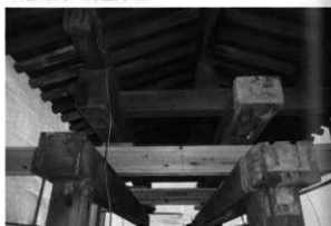
三府御門 冠木、助木と敷桁と添木間離脱
