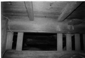
エン床下窓連子欠損
