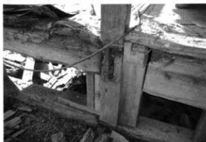
いノ三柱脚部土台腐朽
