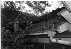
南エンと渡り廊下接合部雨漏り腐朽
