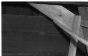
三府御門 冠木離脱 当初柱柄と鼠走り止めかわし蟻穴
