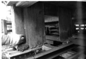
腰板残存 (土台は欠損)
