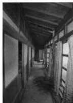
南エン天井雨漏りによる腐朽
