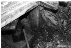
をノ八柱脚土台腐朽
