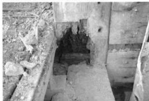
はノ五柱腐朽 足固め接合部
