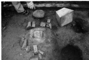
エン東石 コンクリート東下より木束の当り
