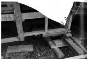
八通りは～へ間土台50cmを残し欠損
