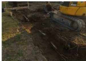
図1-5 き損現場の状況
