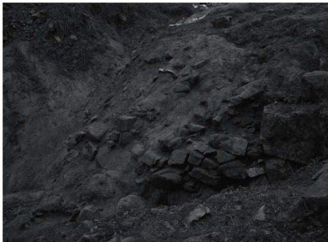
第 45 次調査 大石垣正面 積石崩落状況（南から）
