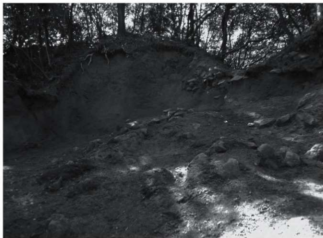
第 48 次調査 崩落部 調査前草刈後状況 南壁部（東から）
