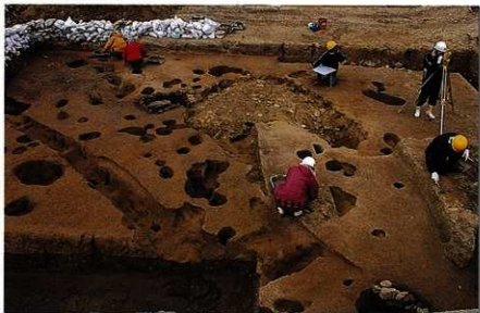
検出された遺構⑤ ビット群および溝状遺構(西から) 遺構の完備作業と測量作業を行う。
