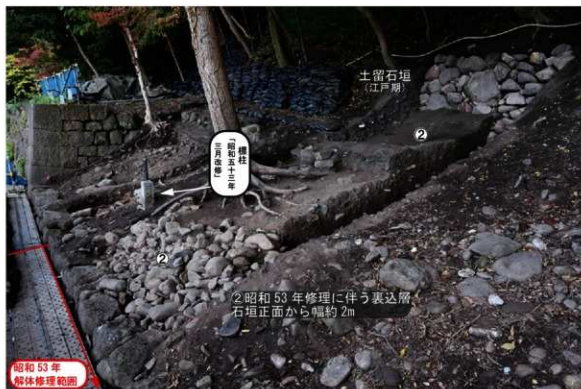
T 4 調査区全景 (南西から) 昭和53年解体修理範囲の北端を確認
