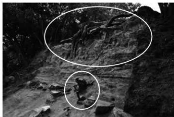
写真5-1 松の根による土塁の被害状況
