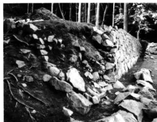
3号石垣南隅部 (崩塌状況)
