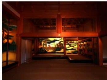
沈下した床(昭君の間)
