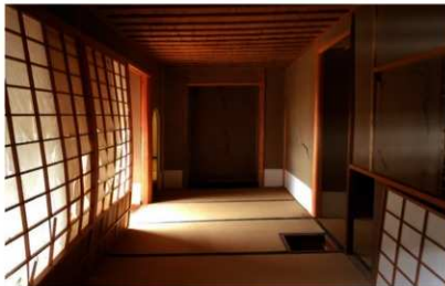
軸組がゆがみ、壁にひびが入った本丸御殿内部(数寄屋棟)
