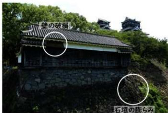
平櫓の被害状況（平成28年〔2016年〕4月）
