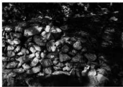
写真7 TT2法敷石垣崩落状況（東から）
