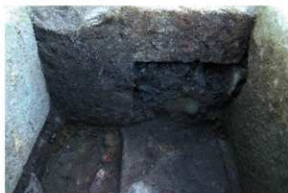
5 SB305集水枡内面 (北→) L字形の石材を用いて入水口を作る。
