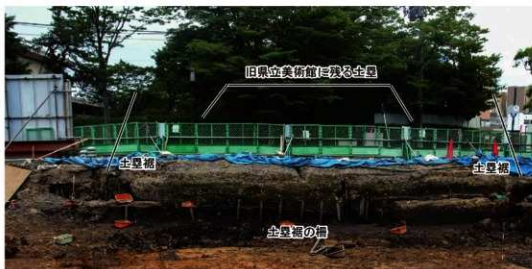
1 旧県立美術館の土壁と土留柵 (西→) 旧県立美術館からのびる土壁の末端を土留めする杭列=土留柵を抜出。
