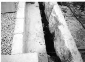
28. 倒れ防止アンカーボルト (基壇部分)
