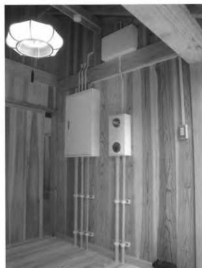
84. 左: 電灯盤、中: 総合盤、上: センサー収納箱
