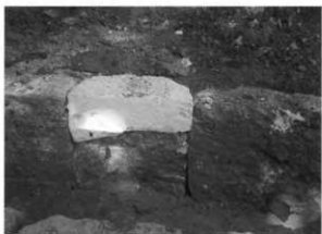
13. 排水溝設置 (破損箇所)
