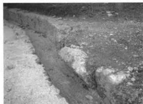
10. 石組排水溝（倒れ箇所）
