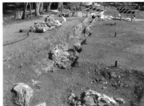
6. 石組排水溝（欠損箇所）
