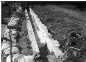
12. 排水溝設置 (欠損箇所)
