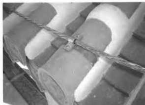
83. 避雷鋼線 (軒丸瓦に固定)
