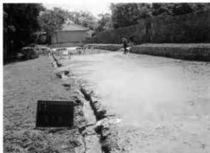
20. 舗装着手前 (西の御番所跡前より東方)
