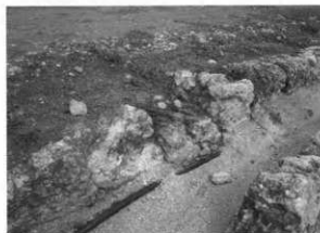
9. 石組排水溝（破損箇所）
