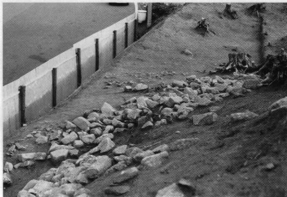
東側Ⅱ段斜面葺石崩壊状況（北西から）
