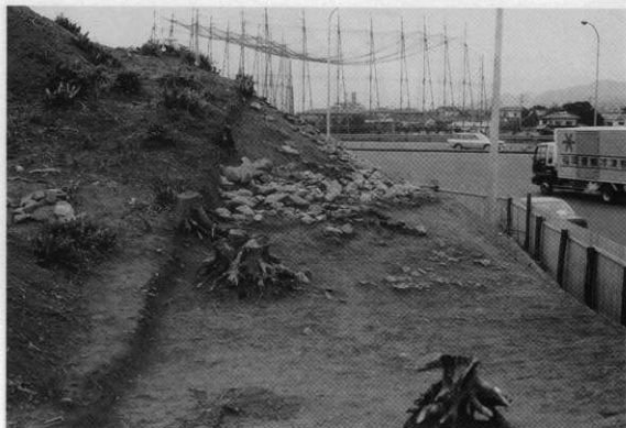
東側Ⅱ段斜面葎石崩壊状況（南東から）
