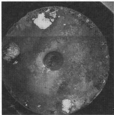
1の鳥居柱接合部「錆」検出状況
