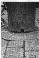
右柱下穿穴痕跡
