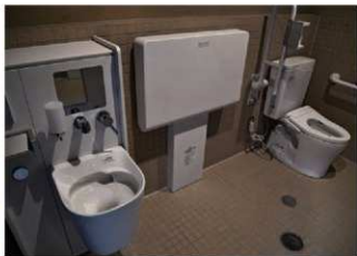
機械設備（給排水衛生設備）
