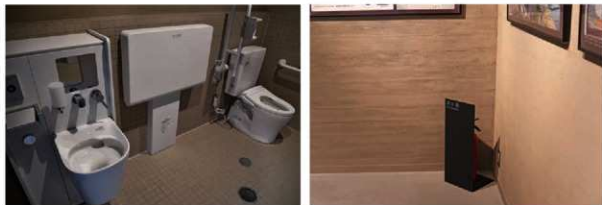
第 140 図 機械設備設置状況 (左: 給排水衛生設備 右: 消火設備)
