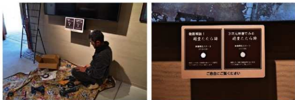
第166図 映像再生装置設置状況
