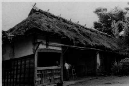
27 破損状況 背面屋根
