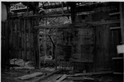
29 破損状況 下郎部屋
