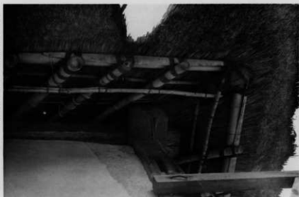
26 破損状況 東南隅の屋根
