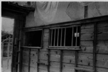
39 現状変更要旨二別表 門番部屋南より第一、二間の 後補の格子窓
