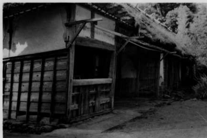
22 破損状況 背面通り
