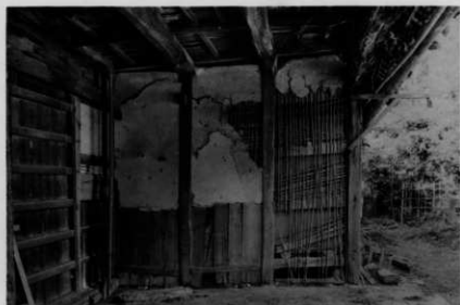
24 破損状況 長屋通り西側
