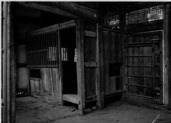
20 修理前 門番部屋間仕切
