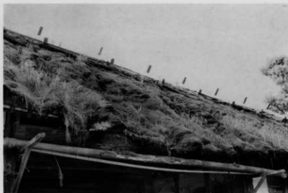
25 破損状況 背面屋根
