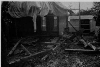
28 破損状況 男部屋(西端)
