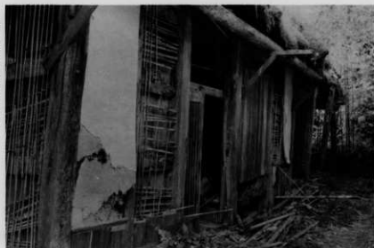
23 破損状況 背面通り
