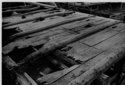
30 破損状況 長屋通り天井
