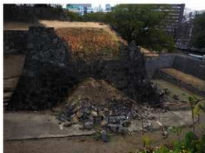
H233 石垣崩落状況
