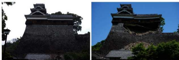
図2 飯田丸五階櫓、南から（左：被災前、右被災直後） (218)
