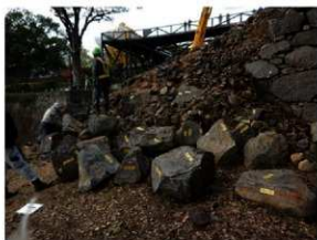
H204 石垣崩落状況
