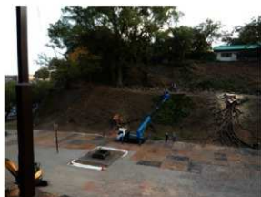
H118 石垣崩落状況
