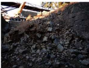
H209 石垣崩落状況
