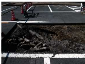
陥没状況確認（東から）
