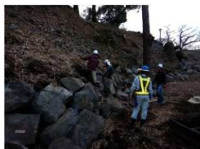
H118 石垣崩落状況
