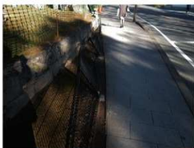
き損状況 (南から)
