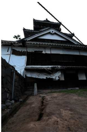
宇土櫓前地割れ状況 (南から)
