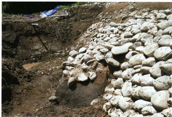
旧堤防 A. 南側崩落部分（北より）
