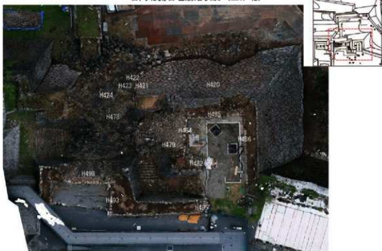
石門周辺石垣崩落状況（上が北）
