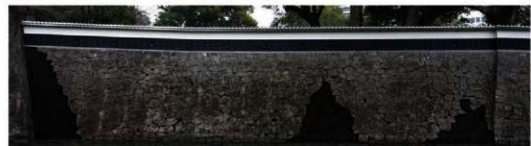
H594（上）、H596（下） 平成28年熊本地震本震後崩落範囲
