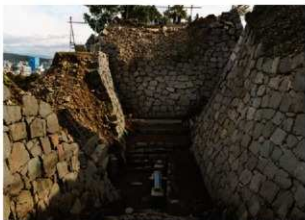
石門南側 崩落石材回収後 (西から)
