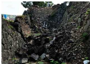
石門南側 崩落状況 (西から)
