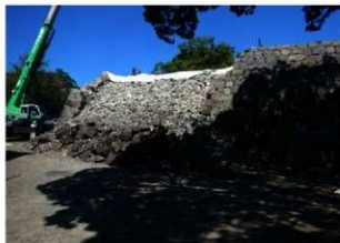
崩落石材回収前の状況（南から）
