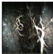
③ 深さ 0.25m 石段（左右）間が土砂と根で詰まる
