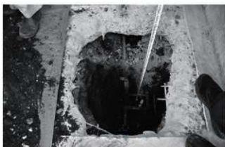
写真49 漏水管発見状況 (北より)
