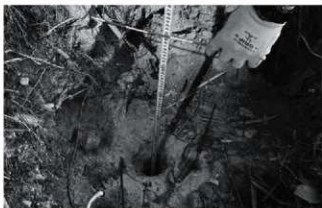
写真70 空洞確認状況 (西より)
