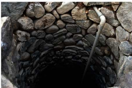
井戸に水が溜まっている状況
