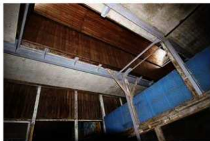
湯気抜きのボルト
