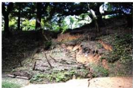
令和3年8月19日等覚寺の松会・松庭傾斜面崩落状況(東より)
