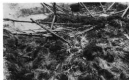
⑫ 鎮火後 柱が中央で折れている（北西より）
