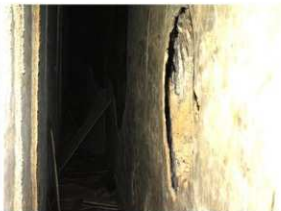
第3弾薬庫跡（剥離及びびアスファルトフェルト）
