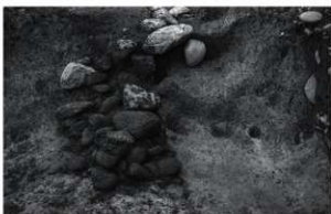
2. 18号・10号溝接続部石崩落状況（北から）
