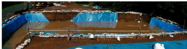
2トレ冠水状況 (9/18)
