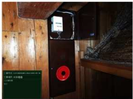
30 火災警知設備設置完了状況（米味噌倉）
