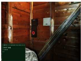
28 火災警知設備設置完了状況（網倉）
