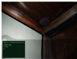
13 火災報知設備点検完了状況（主屋）
