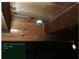
20 火災報知設備設置完了状況（文書庫）
