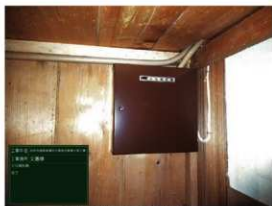
18 火災報知設備設置完了状況（文書庫）
