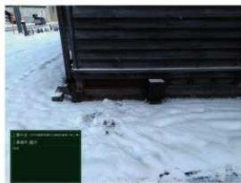
11 火災報知設備点検完了状況（主屋）
