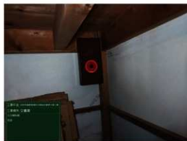
21 火災報知設備設置完了状況（文書庫）
