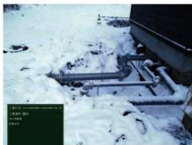
2 消火栓管配管状況
