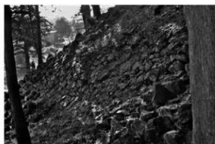
写真12 石垣山城 南曲輪崩れた東側築石部
