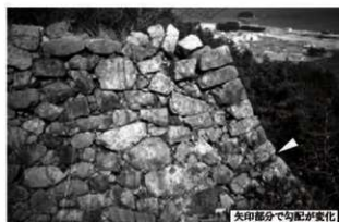
① 西生浦倭城 山上部隅角部 矢印部分で勾配が変化 控えが短く、算木積みとならない隅角部。
