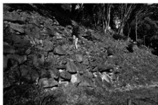
写真13 石垣山城 南曲輪崩れた南側築石部
