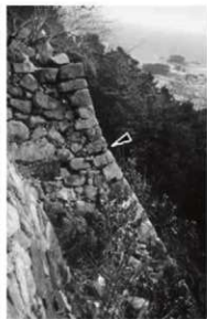
② 左写真と同一箇所
