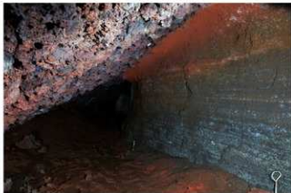
隧道内現況(出口より28m・土石流堆積状況) 東から
