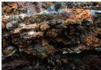
写真398 写真397の被膜痕のアップ
