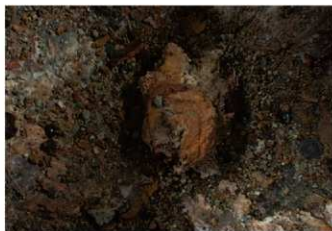
写真339 鉢内面に突き出した鉄管のアップ
