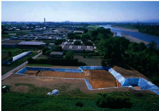
5区2面全景（北西から） 左上の煙突は宮柴前遺跡の所在する伊勢崎市清掃リサイクルセンター 21
