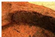
SL1 壁面硬化状況（南から）
