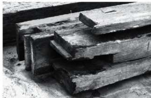
写真2 土台継手部分。雇い鎌納を使った継手。写真正面は上面となり、写真上面は土間内部側となり、付け榑端が見える。木口には胴付きが刻まれていることから、この材は男木である。
