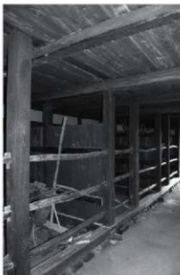
写真3 旧富沢家馬屋 厩栓棒を入れる柱及び間仕切りの柱には、土台が入れられている。
