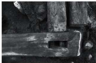
写真7 南西隅の土台隅の納まり。平納が差され、隅柱の重納に対応するため、二段に穴が刻まれている。
