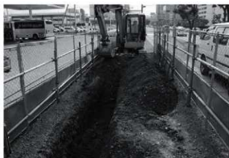
22区攪乱状況 (東から)
