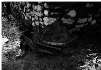
6 5号屋敷跡西側土壁変形の様子 北東→
