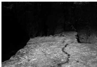
6. 地割れの土層断面(南から)
